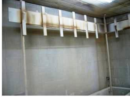
Resim 2.15: Kabin duvarlarında bulunan su perdesi
