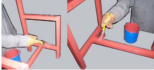
Resim 1.9: Katlar arası 10-15 dakika beklenecek şekilde astar boyanın yapılması
